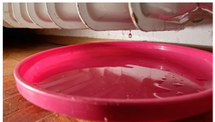
Nicht aufbereitetes Heizungswasser führt dazu, dass Heizkörper schnell korrodieren und undicht werden.
